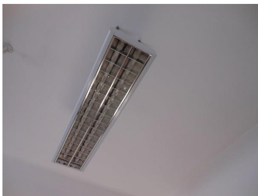
Figura 4.16 - Particolare dei corpi illuminanti
