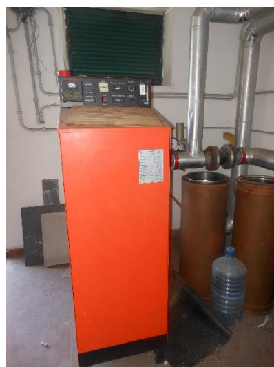
Figura 4.12 - Particolare della caldaia
