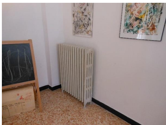
Figura 4.7 – Particolare dei radiatori
